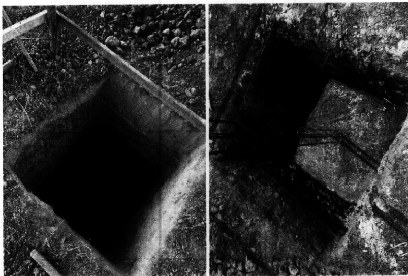
Foto 02 – escavação dos blocos de fundação dos serviços do muro de proteção e varanda
